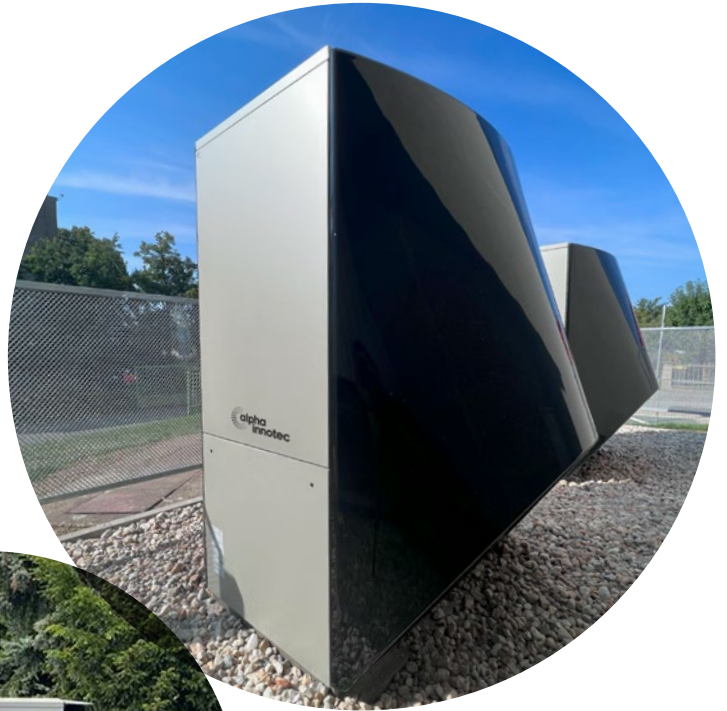
Venkovní instalace 2X LW 251A
