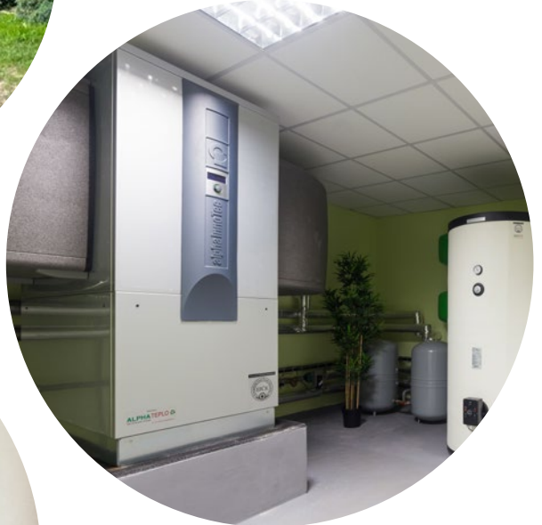
Vnitřní instalace LW 251
